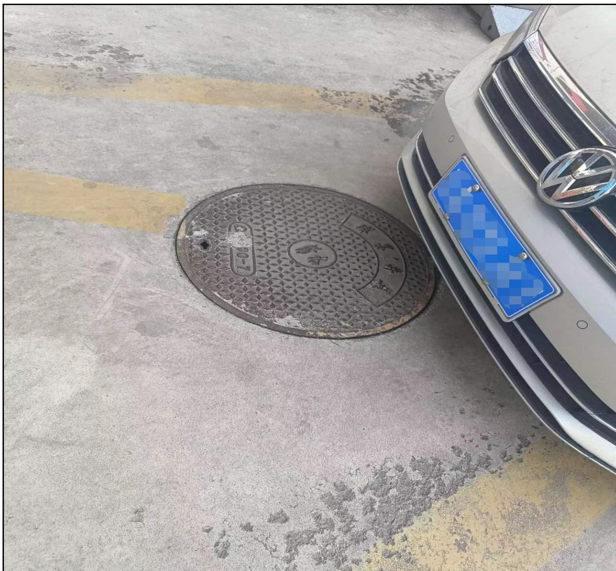
图 5.1-5 化粪池现场照片
