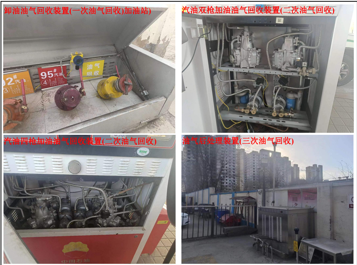
图 5.1-4 三级油气回收系统现场照片
