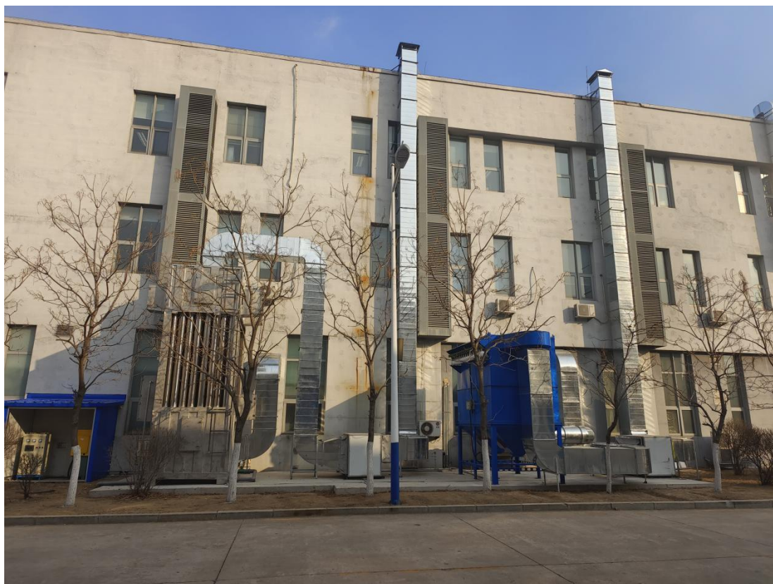
布袋除尘器装置
