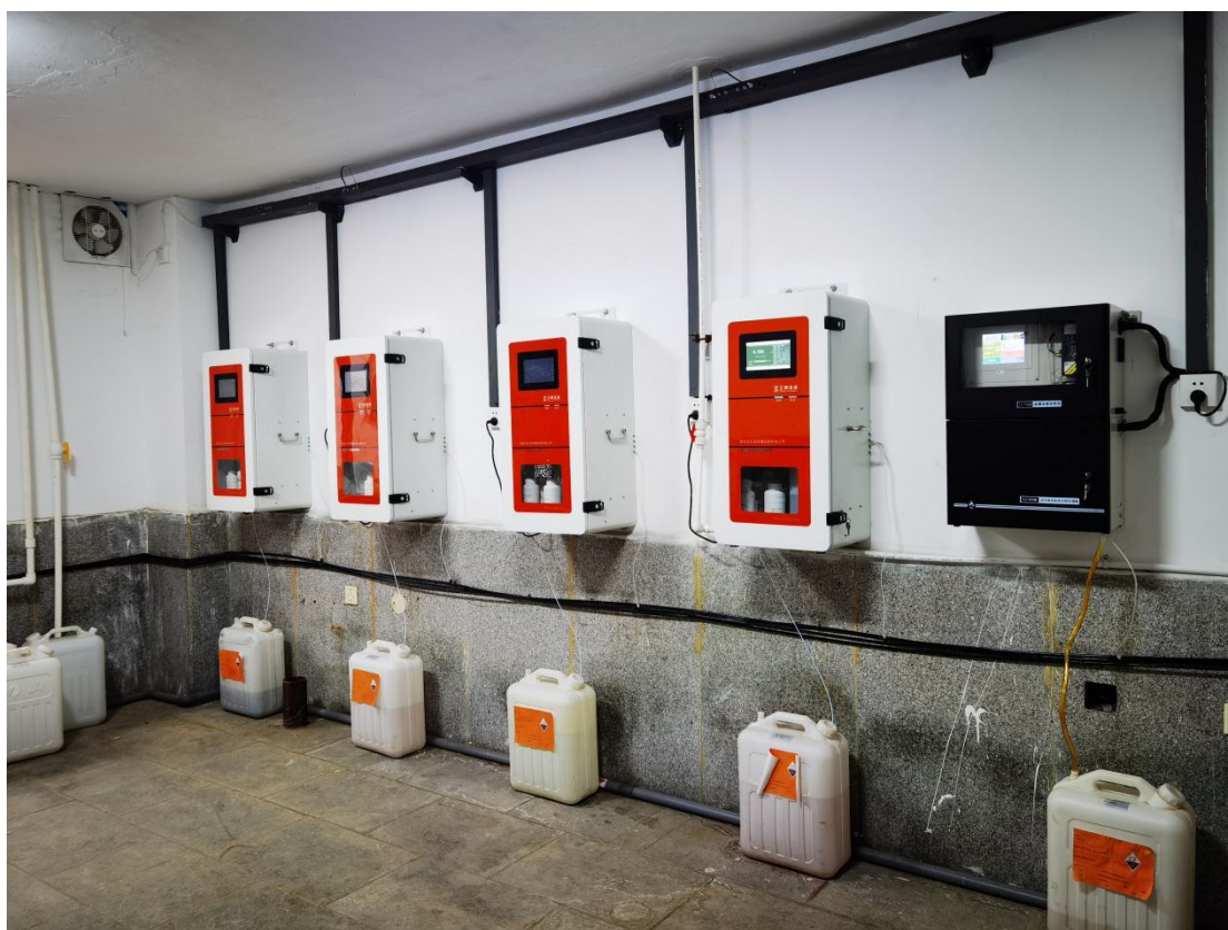
废水在线监测设施
