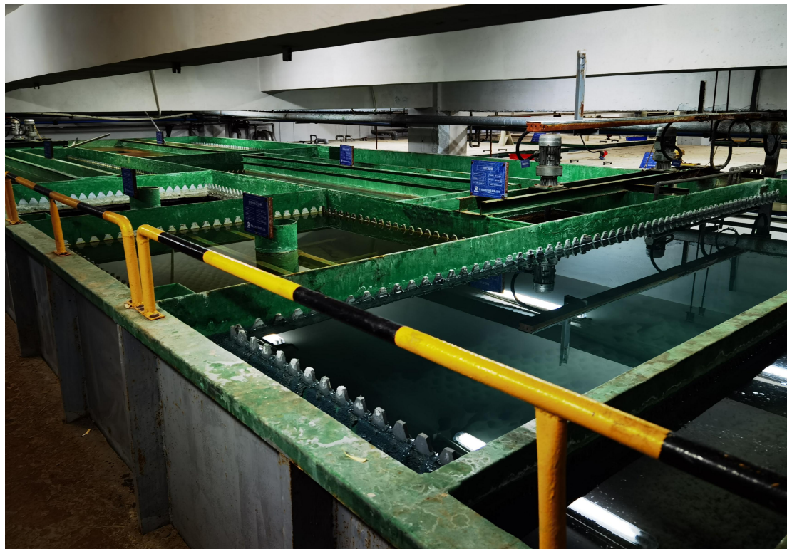
废水处理设施
