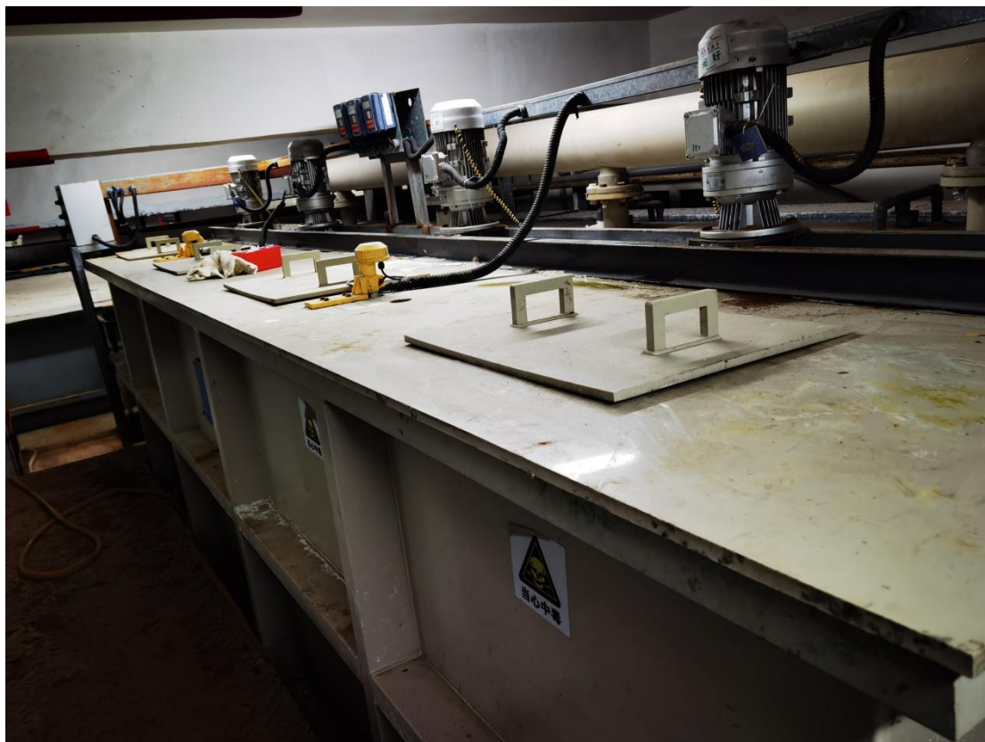
废水处理设施
