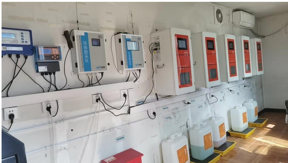
废水在线监测设施
